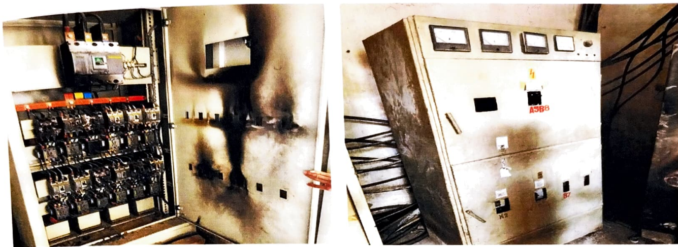
TRẠM BIẾN ÁP BỊ SÉT ĐÁNH
